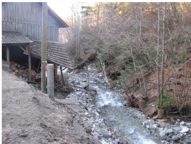
Poškodovana brežina v območju gospodarskega poslopja, katerega vodna ujma delno poškodovala.
